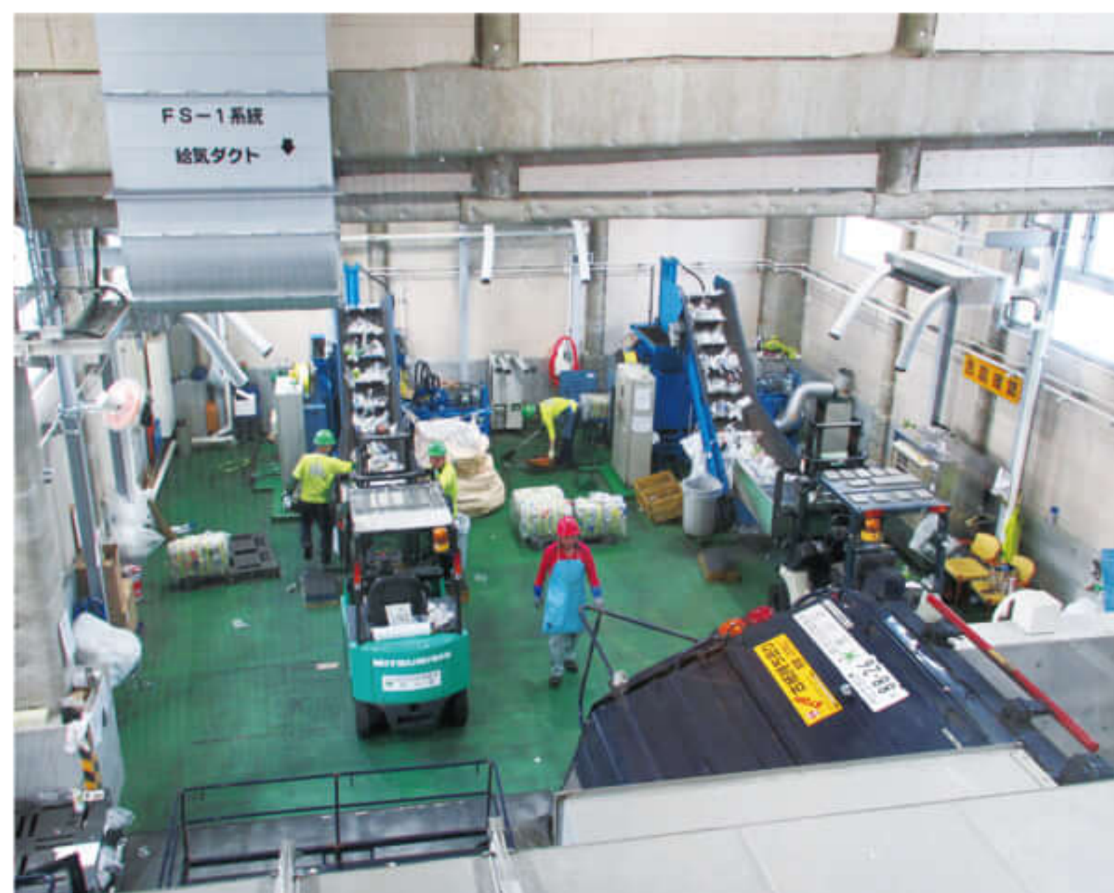
PETボトルの圧縮・ペール処理
